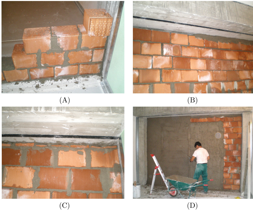
Figura 3.11: dettagli costruttivi della parete di partenza, per la misura del potere fonoisolante massimo apparente relativo a pareti pesanti in muratura di tipo C; (A) dettaglio di posa di blocchi e giunzioni, (B) e (C) riempimento bordo superiore mediante malta e blocchi frammentati, (D) applicazione dell'intonaco.
