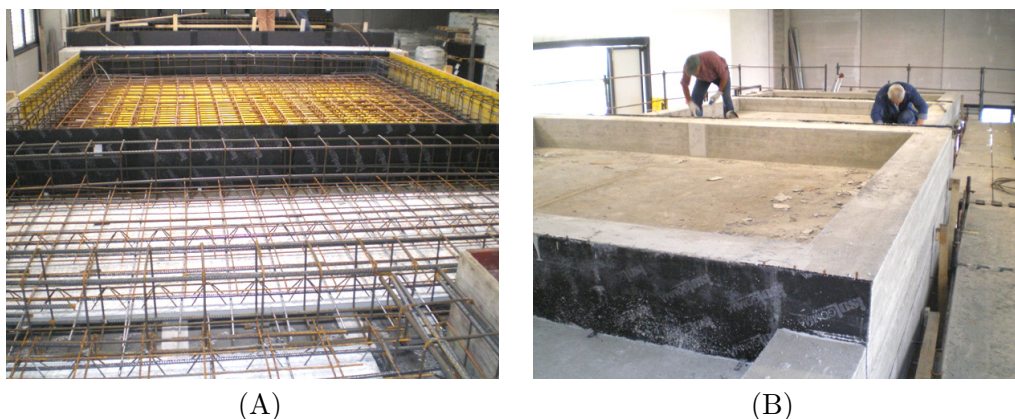
Figura 2.10: (A) dettaglio della disposizione dei ferri di armatura dei solai (in primo piano il ballatoio a servizio del solaio in calcestruzzo); (B) dettaglio del solaio in laterocemento.
