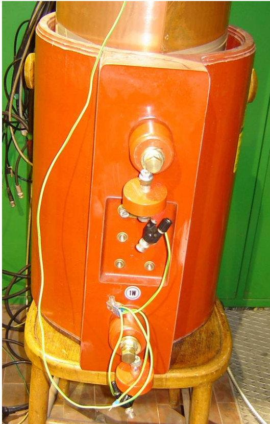
Figura 10-7: Bobina di media tensione appartenente ad un trasformatore da 50 kVA – 20 kV.
