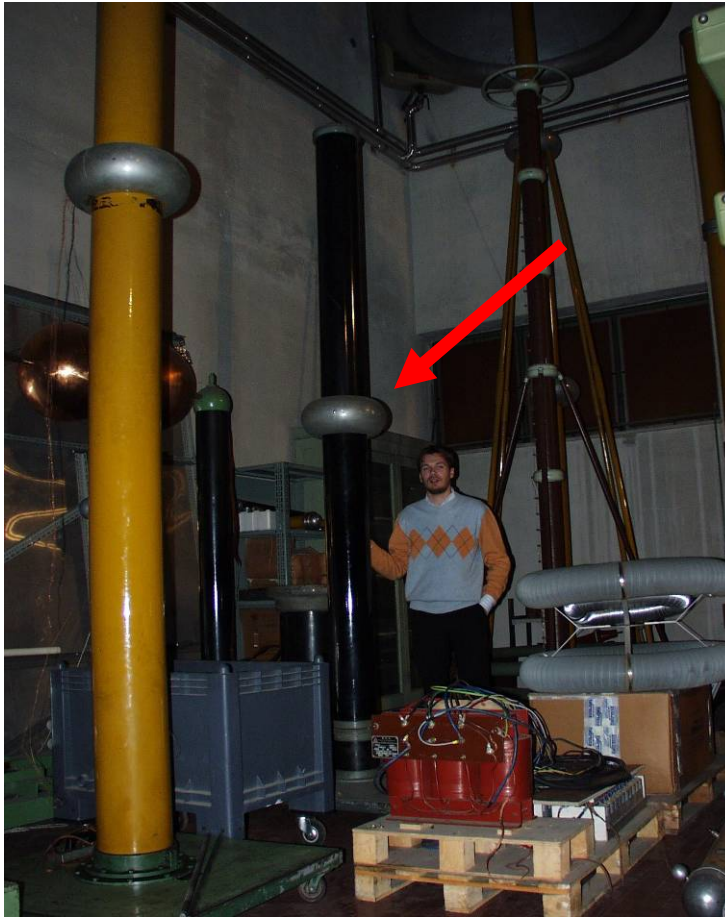
Figura 4-19: Condensatore isolato in carta olio di capacità nominale pari a 500 pF e tensione massima pari a 500 kV efficaci.
