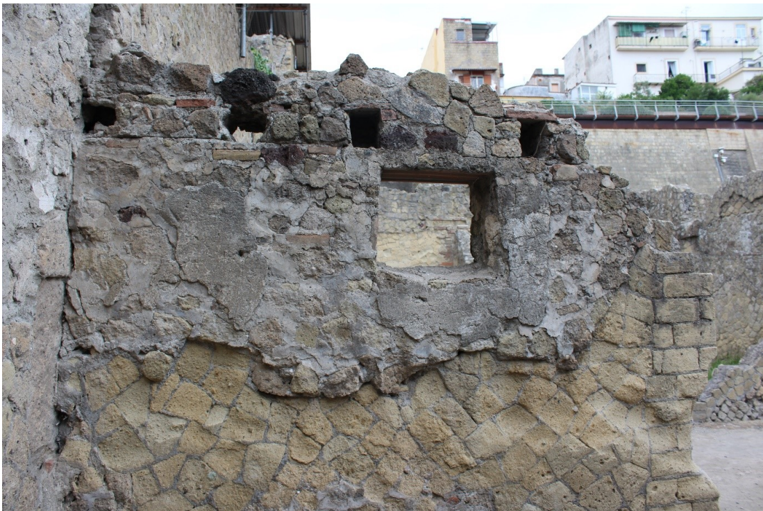
Fig. 38. Casa della colonna laterizia, ambiente 5, parete Nord.
