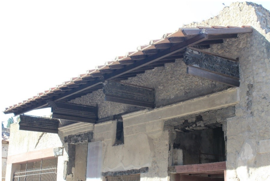
Fig. 25. Tettoia situato lungo un cardo di Ercolano in cui si vedono le travi oblique le quali poggiavano su un elemento orizzontale situato a sua volta al di sopra di travi incastrate nei muri (foto dell'autore).
