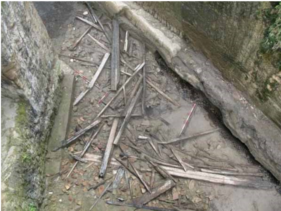
Fig. 23. Il crollo del tetto (immagine tratta da www.archart.it ).
