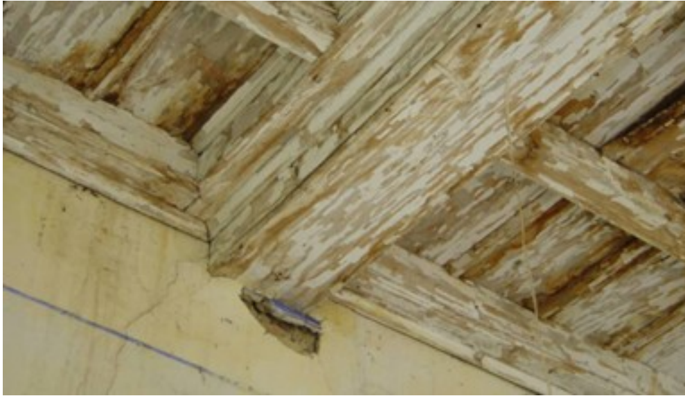
Fig. 9. Appoggio di una trave nel muro: l'elevato carico concentrato ha causato la formazione di fessure inclinate di circa 45° a partire dagli spigoli inferiori della trave; ciò ha provocato, immediatamente al di sotto dell'appoggio, il distacco dell'intonaco (Zamperini 2016).
