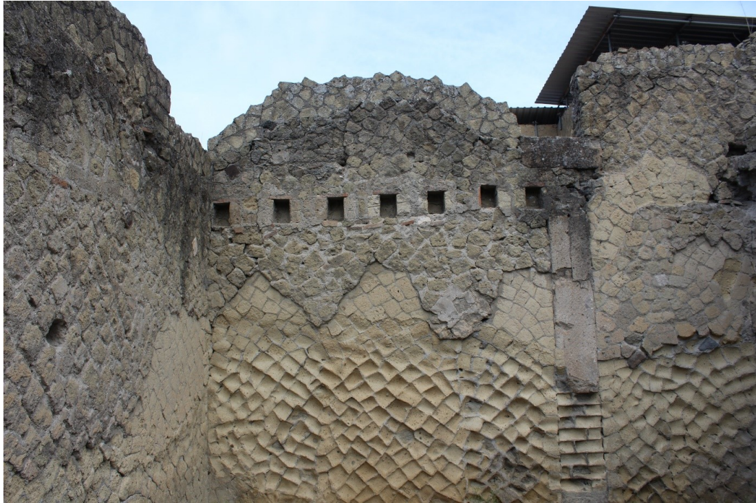
Fig. 37. Casa della colonna laterizia, ambiente 1, parete Nord.
