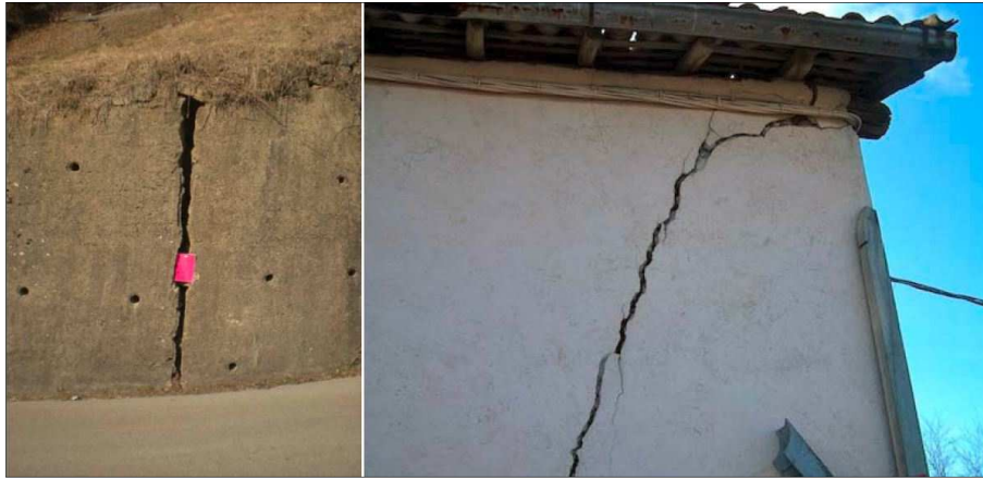
Figura 4.1 - Lesioni presenti su un muro di contenimento ai lati della strada e sugli edifici.
