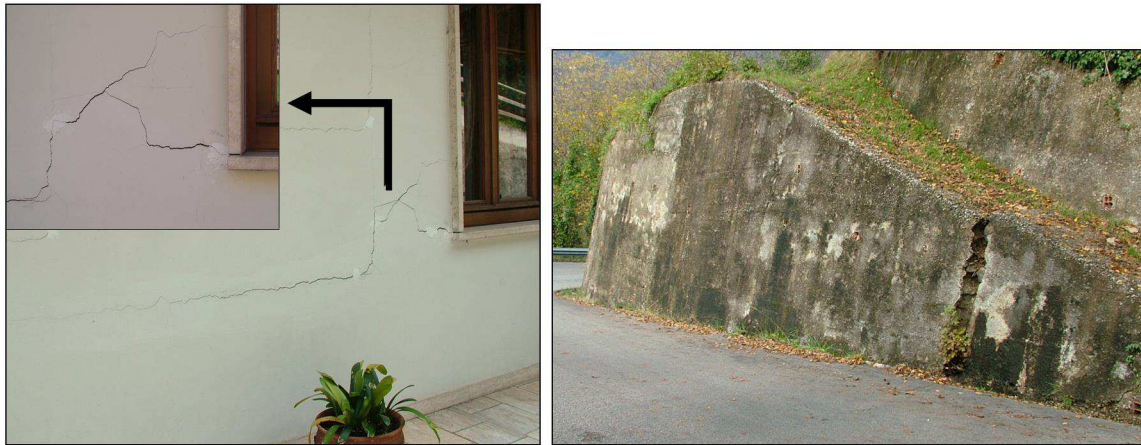
Figura 4.12 - Abitazione ed infrastruttura stradale lesionate a Caneva di Sotto, nell'area della frana n.1, in seguito all'evento alluvionale del novembre 2010 che ha colpito la Provincia di Vicenza.
