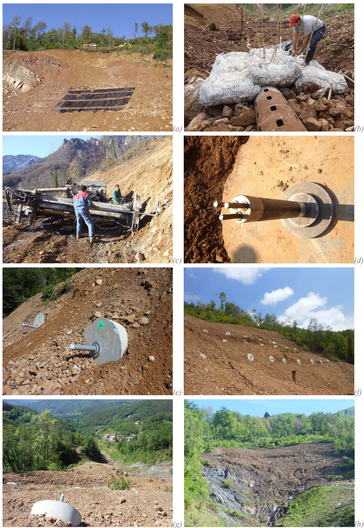
Figura 7.24. Interventi di stabilizzazione della frana di Val Maso: terre armate ancorate (a), drenaggi (b), ancoraggi (c), particolare dell'ancoraggio composito (d), piastra inglobata nel pendio (e), viste d'insieme a intervento concluso (f, g, h).
