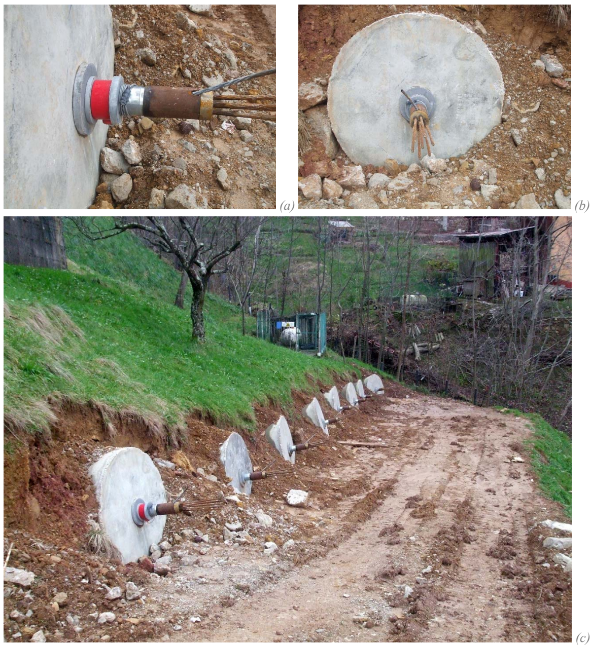
Figura 7.40. Frana Cischele a lavori ultimati: particolare di piastra flottante con cella di carico (a), piastra flottante non strumentata (b) e vista d'insieme (c).
