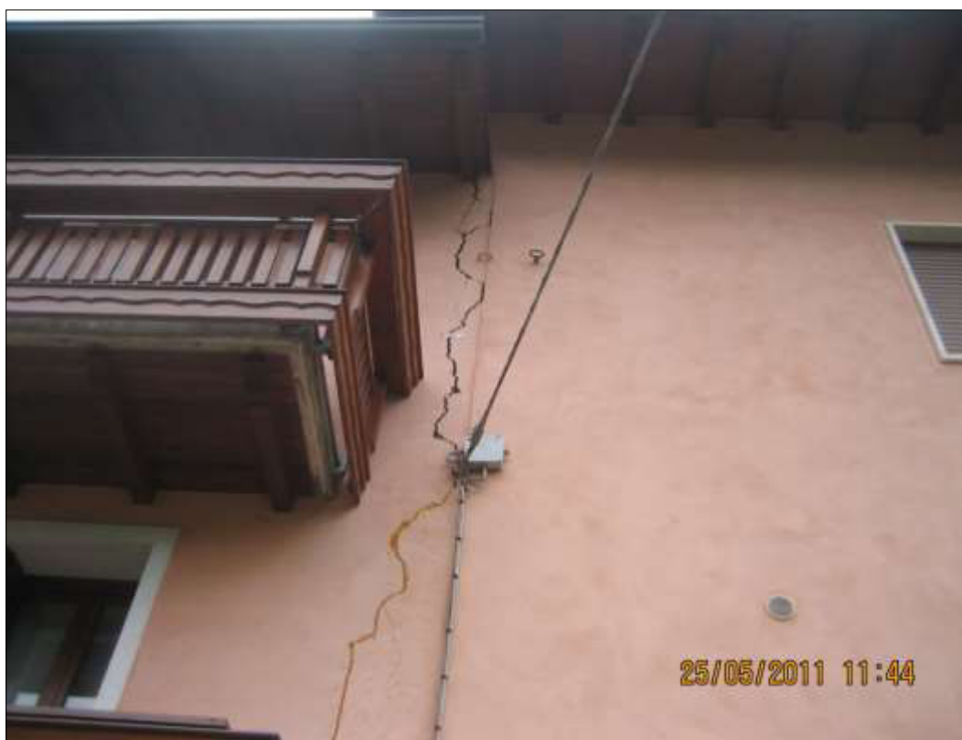
Figura 54 Lesioni su edifici privati a valle della strada provinciale.
