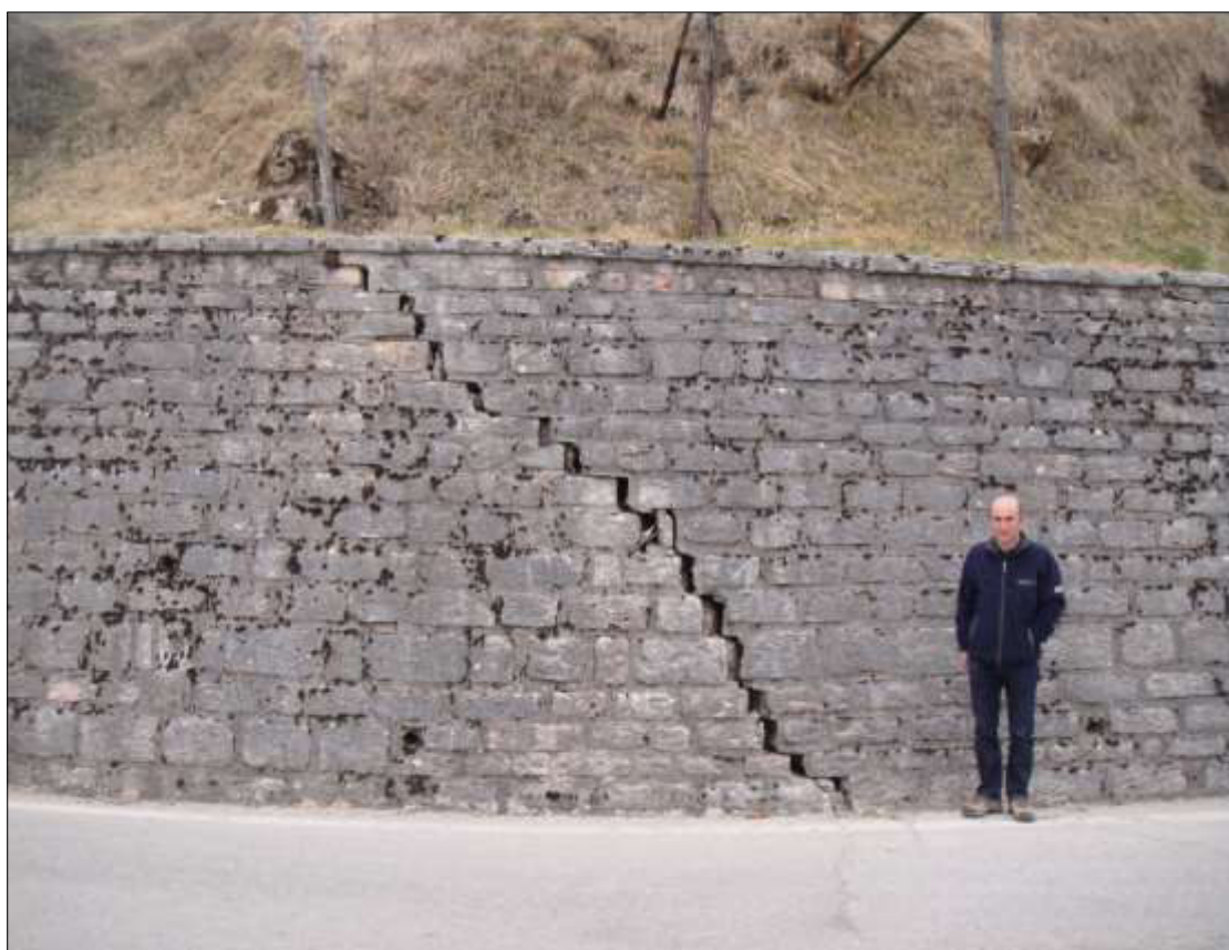
Figura 55 Lesioni sul muro di sostegno a monte della strada provinciale
