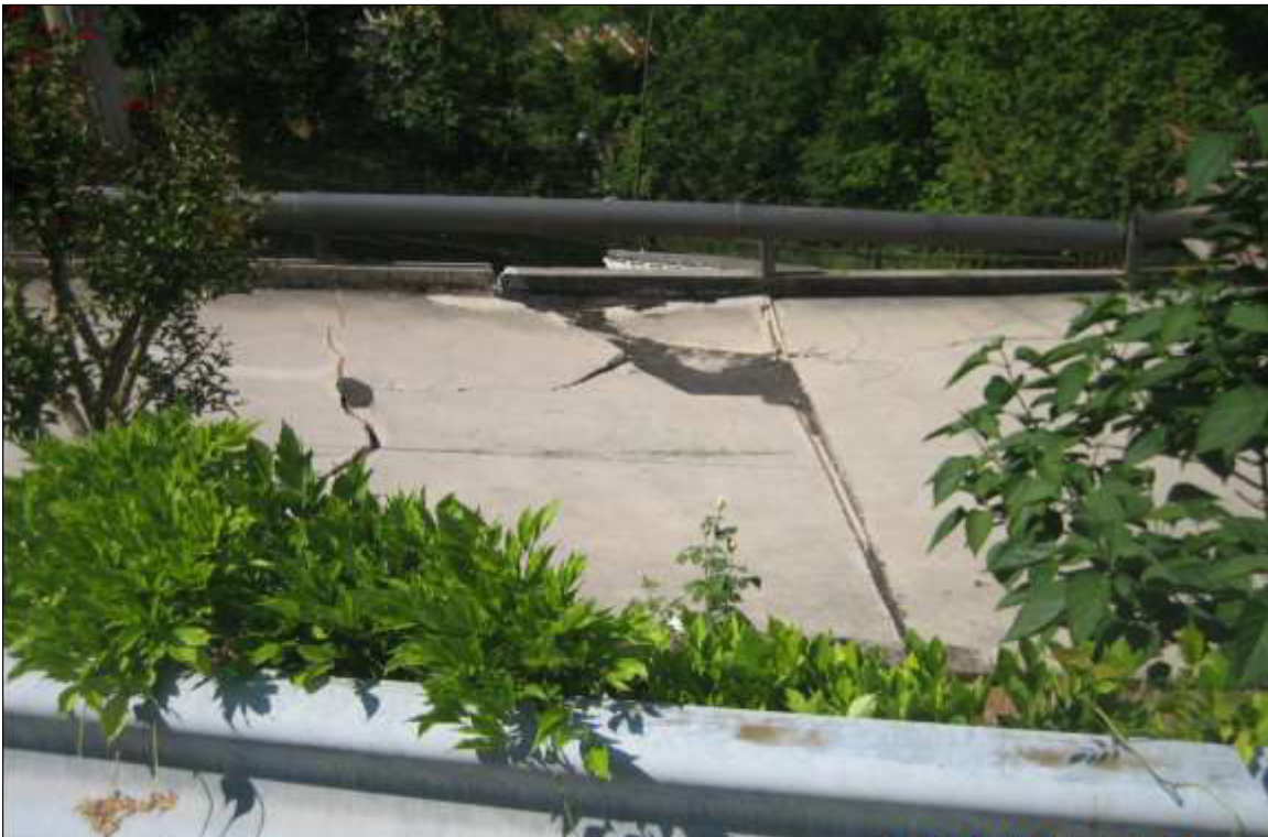
Figura 53 Lesioni su un manufatto privato a valle della strada provinciale
