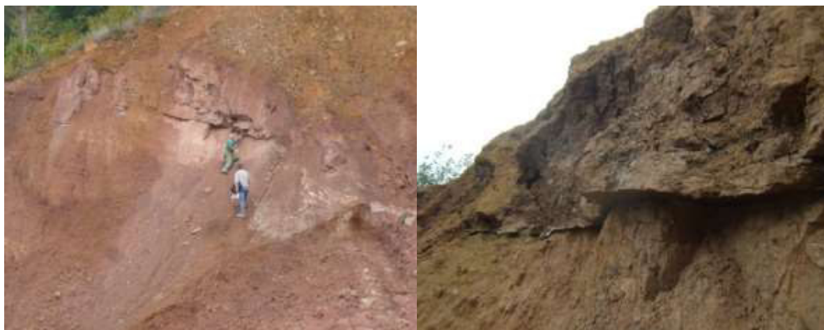
Figura 82 Localizzazione di una superficie di scivolamento connessa all'evoluzione del fenomeno dopo il collasso del versante.
