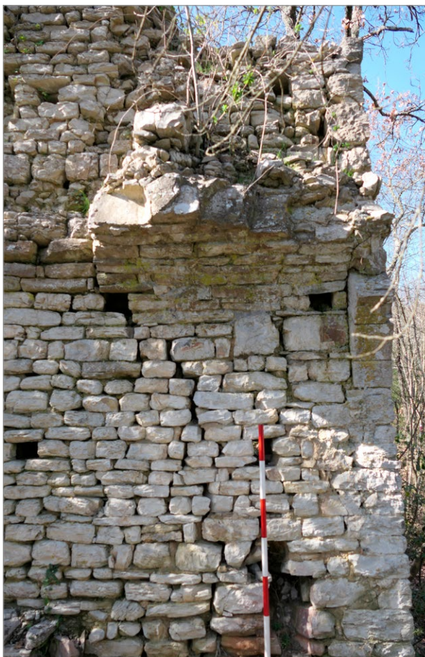
fig. 31 – Monastero di Casignano: resti della volta a botte posta a copertura del piccolo vano di ingresso.
