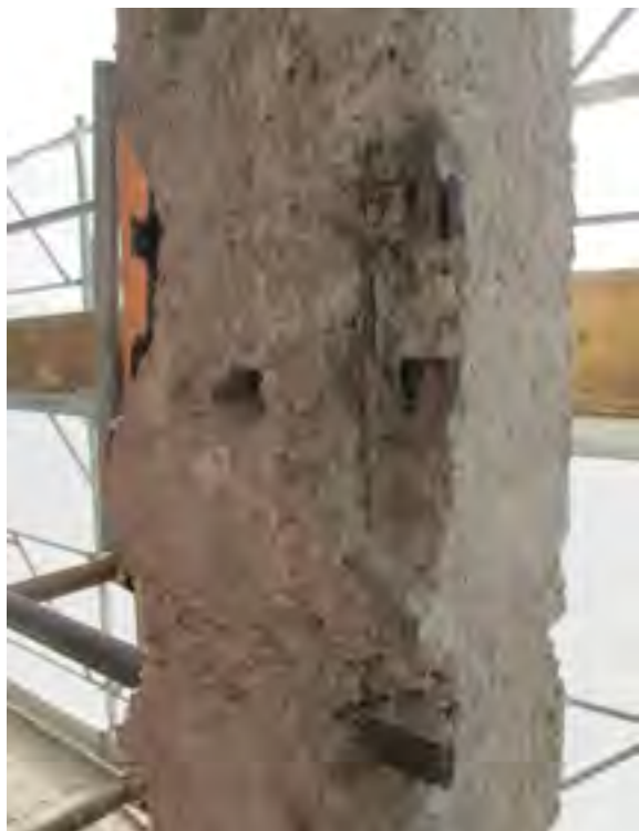
Fig. 80: Padova, castello carrarese, ala settentrionale, piano secondo, pilastro del ballatoio, condizione di degrado dell'armatura cui erano state saldate le grate di protezione.
