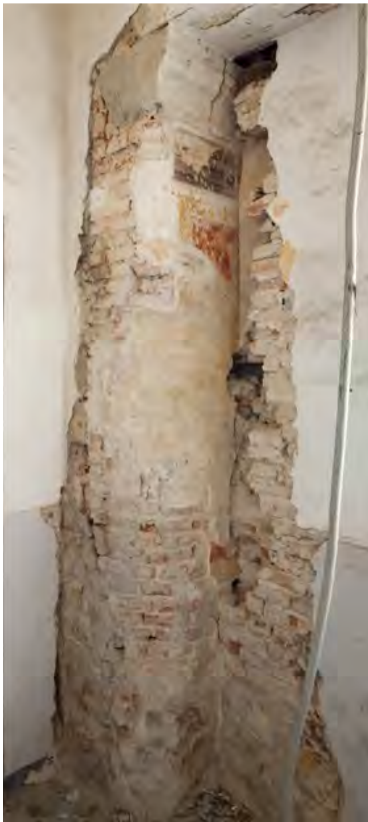
Fig. 95: Padova, castello carrarese, ala orientale, piano terra, loggia, quarto pilastro, lati settentrionale e orientale.
