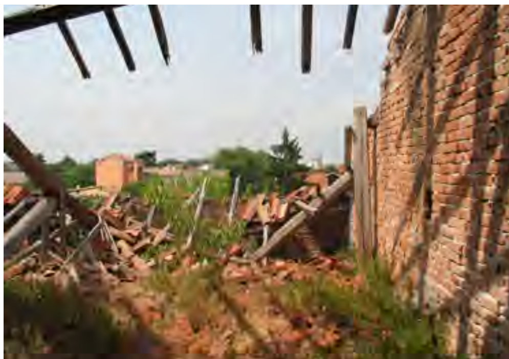
Fig. 82: Padova, castello carrarese, ala settentrionale, settori in crollo della falda settentrionale.
