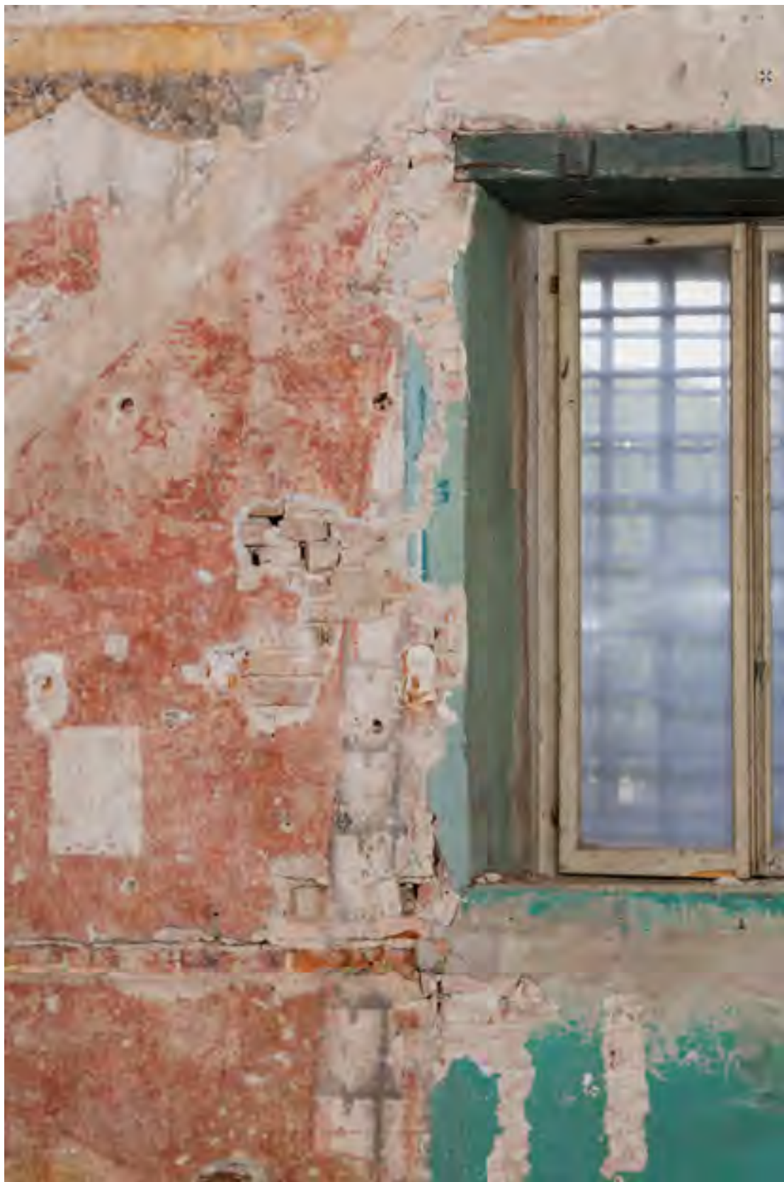
Figg. 134-135: Padova, castello carrarese, torre orientale, piano primo, Sala del roseto con velario , effetti di illusionismo del velario che si discosta in corrispondenza di elementi architettonici reali come le finestre.
