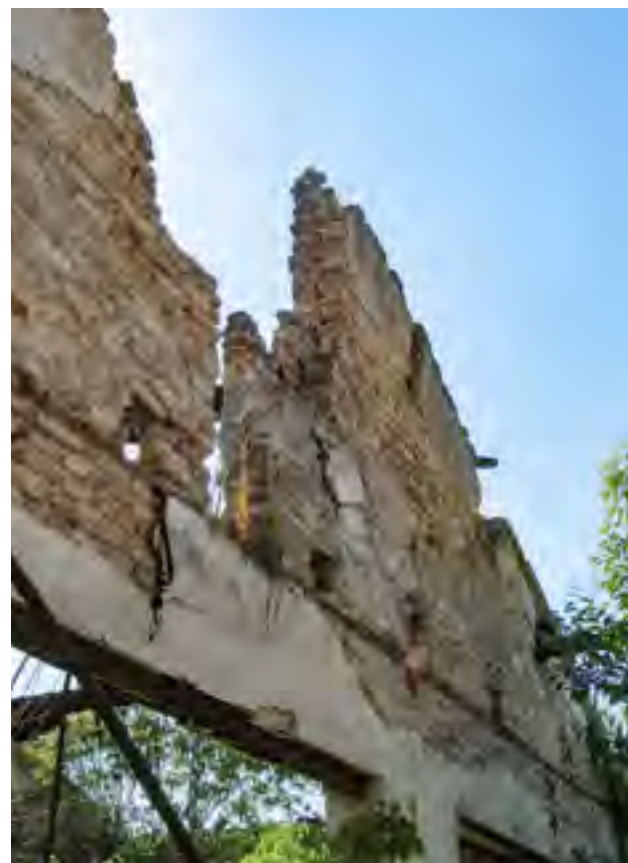
Fig. 112: Padova, castello carrarese, ala meridionale dopo l'incendio della fine degli anni ottanta, setti murari.
