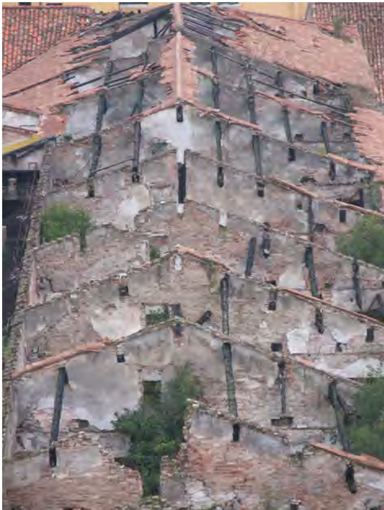
Fig. 111: Padova, castello carrarese, ala meridionale dopo l'incendio della fine degli anni ottanta.
