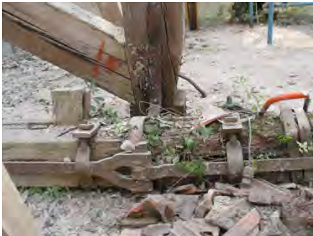
Fig. 81: Padova, castello carrarese, ala settentrionale, nodo di capriata collassato.
