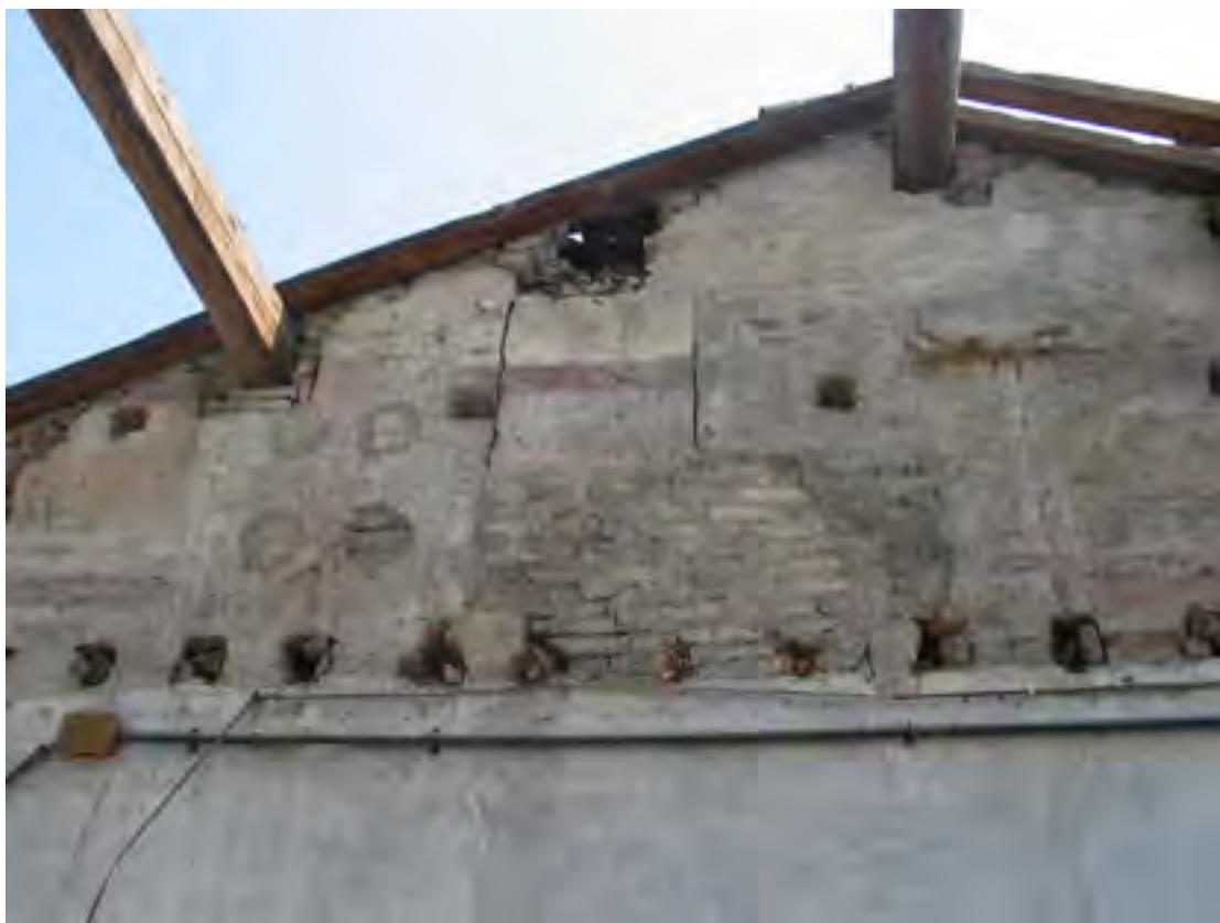
Fig. 105: Padova, castello carrarese, ala orientale, piano secondo, muro meridionale con fasi di modifica delle merlature.
