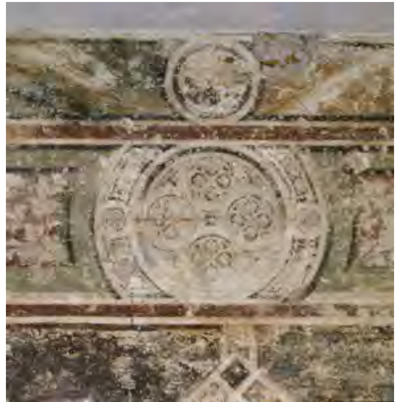
Figg. 28-29: Padova, castello carrarese, ala settentrionale, piano terra, Sala degli ottagoni , particolari.
