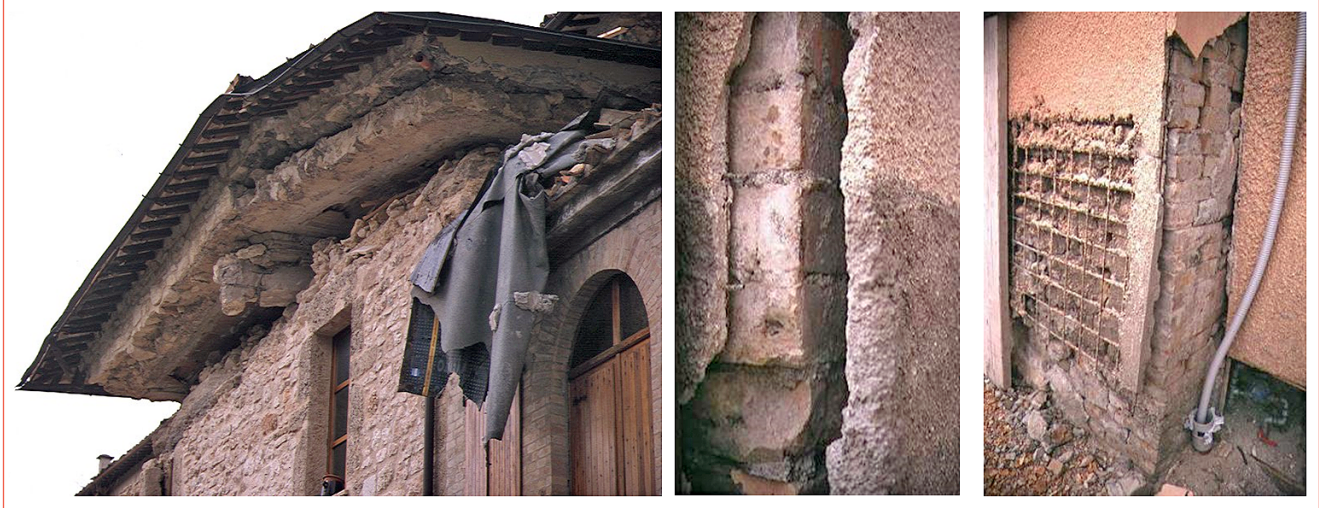
FIGURA 4 Sellano (PG), 1997, terremoto Umbria-Marche. A sinistra: scorrimento del piano della copertura: in occasione di un intervento pre-sisma, la copertura tradizionale era stata sostituita con una copertura più rigida e pesante; nessun intervento di rinforzo era stato eseguito sulle strutture verticali in muratura. A destra: gli effetti dell'evento su strutture verticali irrigidite con paretine armate
