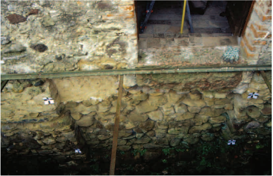
fig. 4 Santa Maria a Elisabetta di Soiano, prospetto nord esterno abside, parte inferiore con due lesene.
