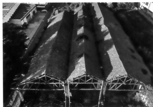
Ex Complesso Montecatini, copertura dei volumi affiancati a via Zecchinel (dall'elaborato di Nikoland Bonjako, Luca Giacomo Invidiato, Rossana Martignon, Carlotta Zaramella).
