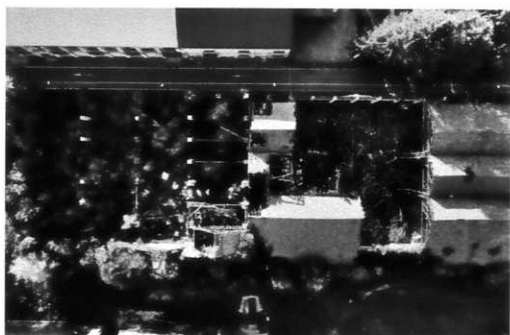
Ex Complesso Montecatini, veduta zenitale della parte del volume disposto lungo via Zecchinell - in alto nella foto - la cui copertura si presenta crollata.
