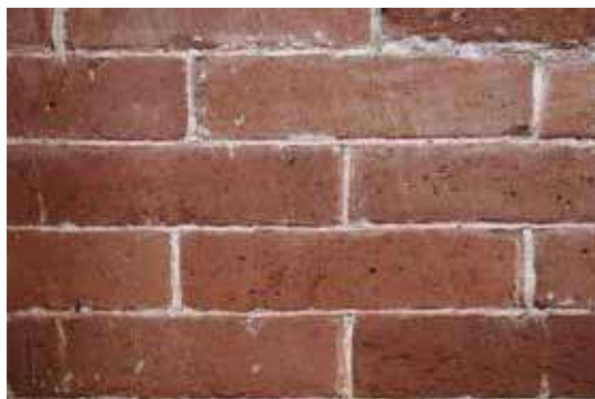
Fig. 6 - Morimondo, abbazia di Santa Maria, chiesa, particolare della muratura di uno dei piloni con la rifinitura dei giunti e la graffiatura dei laterizi (foto di S. Beltramo, 2017-18).
