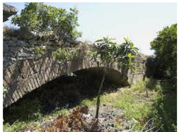
Fig. 4 - Un pezzo del ponte di Limira (fonte: Wikipedia)
