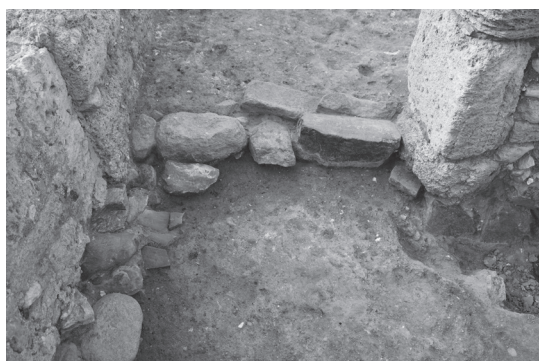
Fig. 8. Nora, saggio PO. La fondazione della soglia tra i vani VII e VIII (US 21548) e l'antistante stesura di malta (US 21545), viste da nord.
