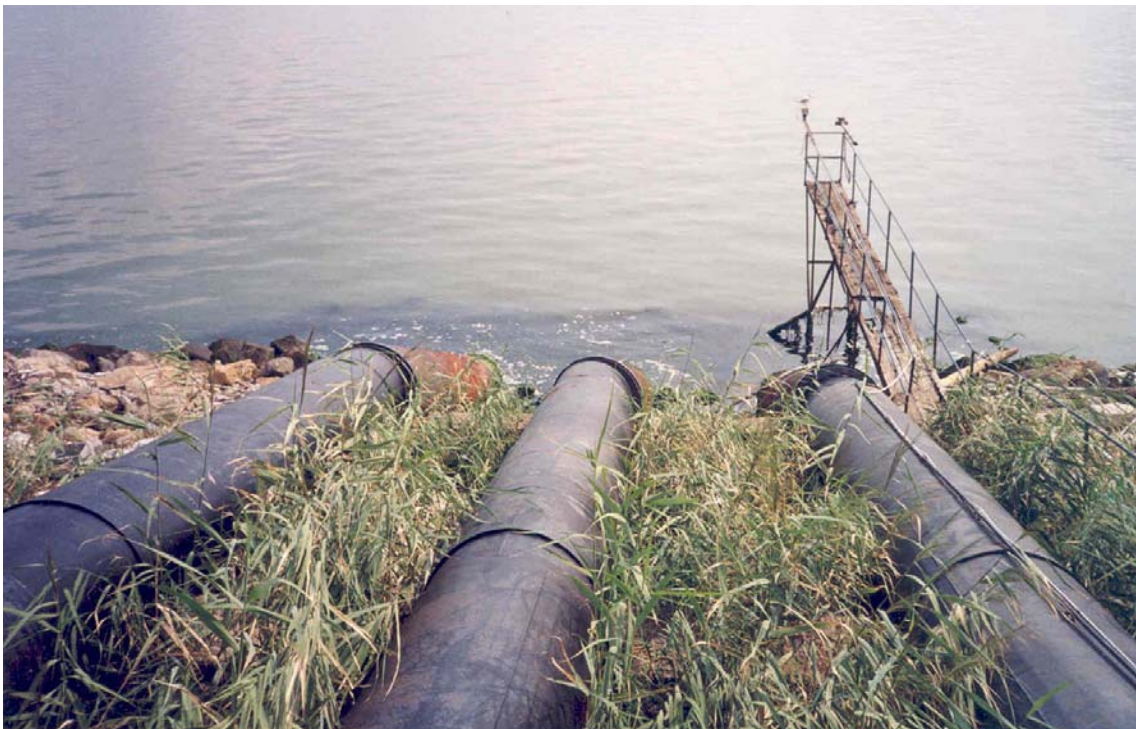
Fig. 6.3 Pompes hydrauliques en fonction dans la commune de Porto Tolle
