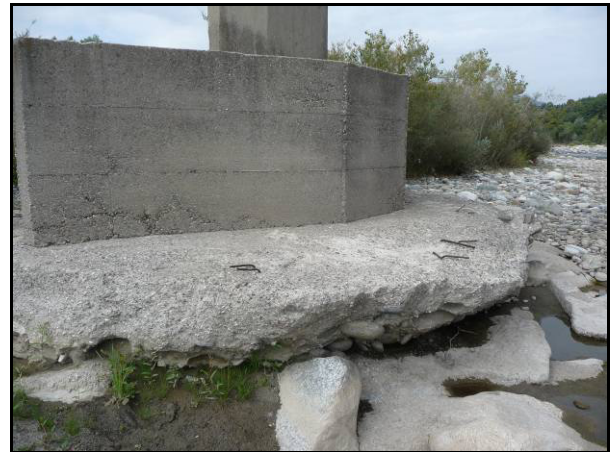
Figura 5.26 - Pile sottoscavate del ponte, ad evidenza del processo d'incisione che ha interessato il tratto di Serravalle.
